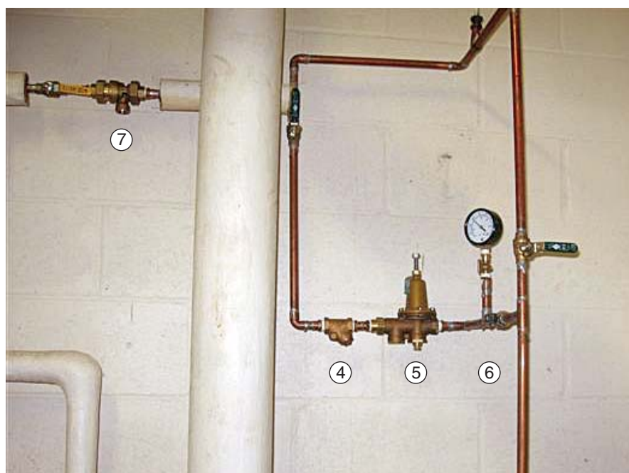
On remarque qu'un clapet simple avait été installé à l'envers (4), le clapet vers le haut, sur le réseau de chauffage. L'entrepreneur a ajouté (7) un DAR à orifice de décharge (DAROD).
