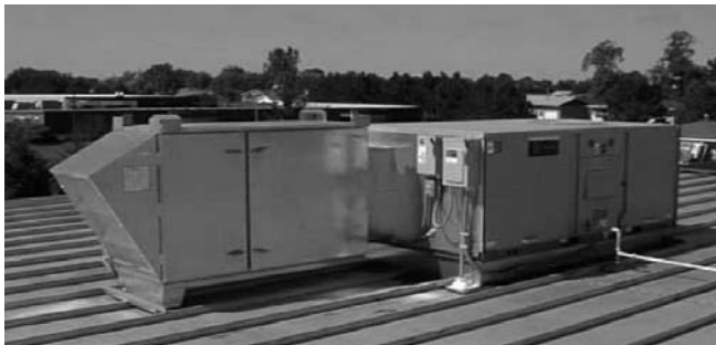
Récupérateur couplé à un climatiseur de toit
