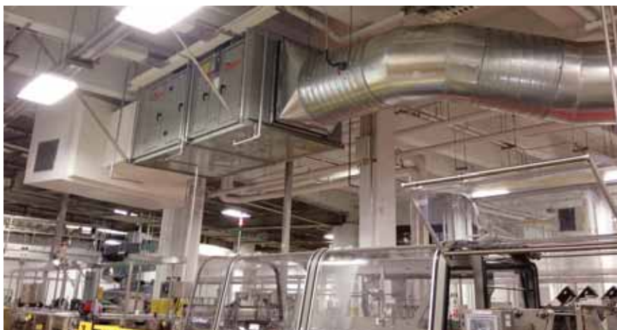
L'une des 3 centrales d'air avec boîte de mélange qui récupèrent la chaleur de l'air au plafond de l'usine.
