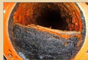
4 : Obstruction d'un système de protection incendie par de la corrosion bactérienne
