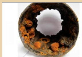
3 : Tubercules présentes dans un système de protection incendie
