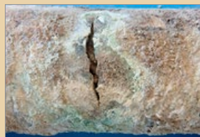
7 : Tube d'un échangeur à chaleur fissuré à cause de la corrosion bactérienne
