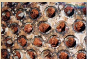
5 : Tubes d'un échangeur à chaleur obstrués par la corrosion bactérienne
