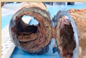
6 : Tube d'un échangeur à chaleur obstrué par la corrosion bactérienne
