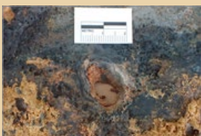
10 : Perforation causée par la corrosion bactérienne
