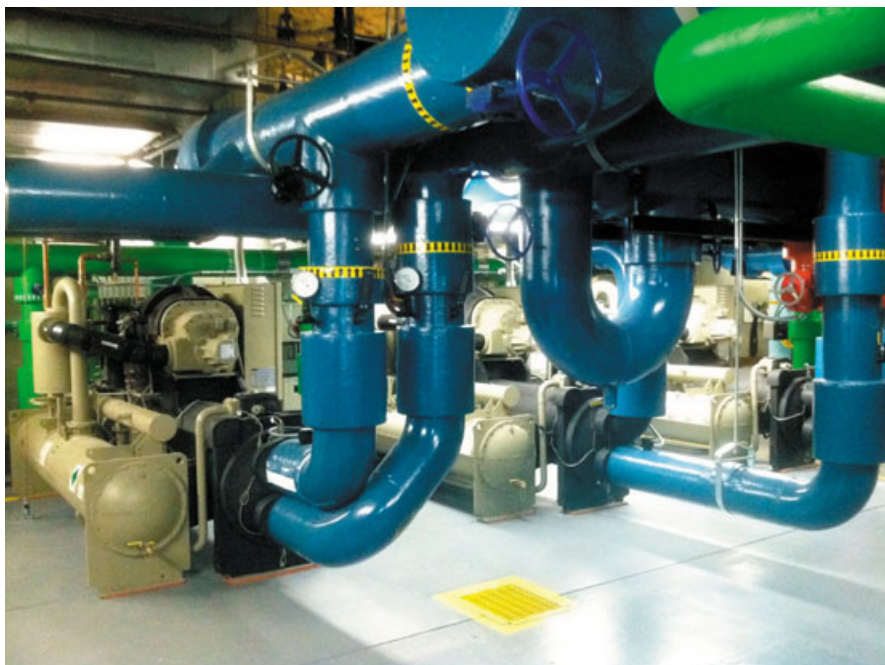
Le Ball Arena de Denver (anciennement le Pepsi Center) utilise le réfrigérant R-513A dans les refroidisseurs servant à fabriquer la glace destinée à l'Avalanche du Colorado.
