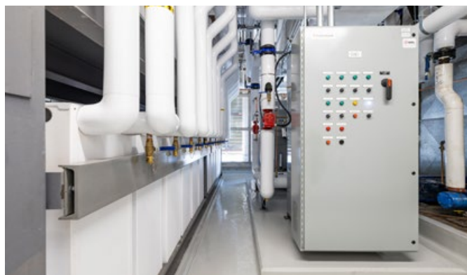
Banque thermique chargée en mode hors pointe par une chaudière électrique externe.
