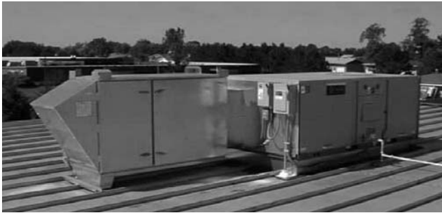
Récupérateur couplé à un climatiseur de toit
