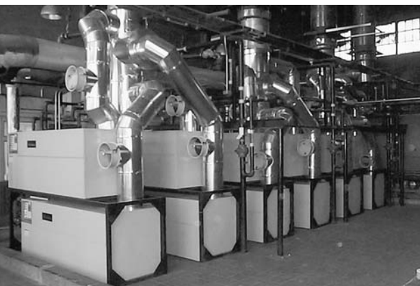
Arrangement des 12 chaudières superposées et divisées pour produire 3 niveaux de modulation.
