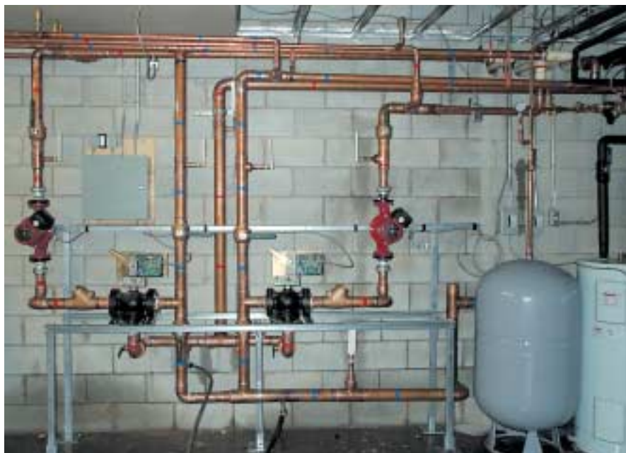
Partie du système de distribution de l'eau de chauffage.
