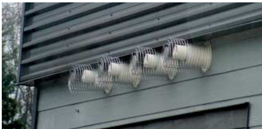
Les 4 conduits coaxiaux sont les seules traversées à l'extérieur pour les appareils à combustion hermétique.
