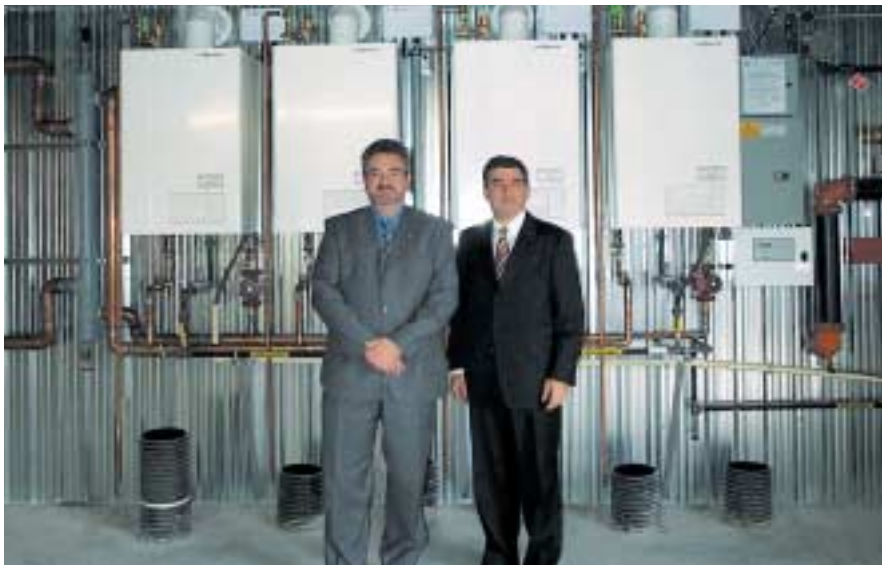
Claude Routhier, d.g. de Poly-Énergie, et Christian Fournelle, d.g. de Groupe Énergie, devant les 4 chaudières à condensation qui chauffent tout le bâtiment.
