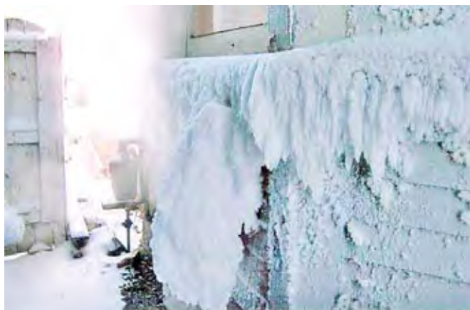
Par temps froid et venteux, les gaz de combustion et la vapeur d'eau peuvent former un bouchon de glace qui bloque la prise d'air frais et la sonde de sécurité arrête la chaudière.
