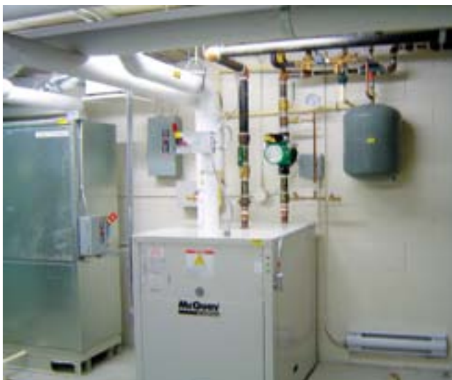
Aperçu du collecteur des boucles géothermiques et d'une des thermopompes eau/eau.
