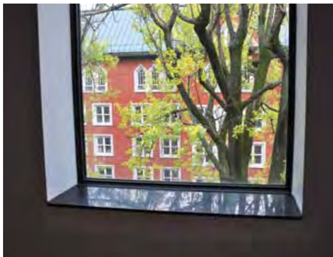
Dans les bâtiments rénovés, des panneaux radiants hydroniques courent sur une partie des murs extérieurs et même sous la tablette des fenêtres.
