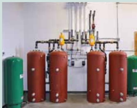
Les réserves tampon chauds et froids du système géothermique.
