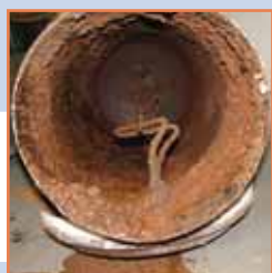
Chauffe-eau conventionnel après quelques années d'utilisation.
