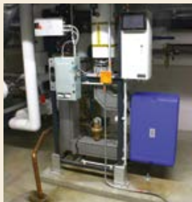
Le petit échangeur de chaleur (en bleu) dans la sous-station de mesure de l'énergie.
