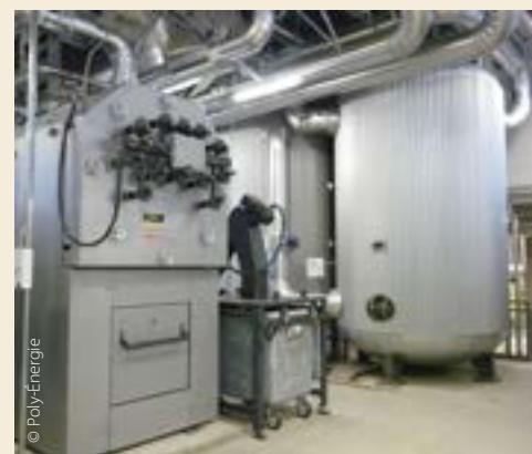
Une des chaudières flanquée de son bac à cendres et des 2 réservoirs tampons de 22 000 L d'eau chacun
