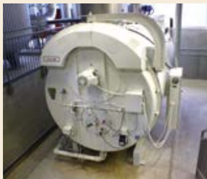
Chaudière de secours à gaz naturel.
