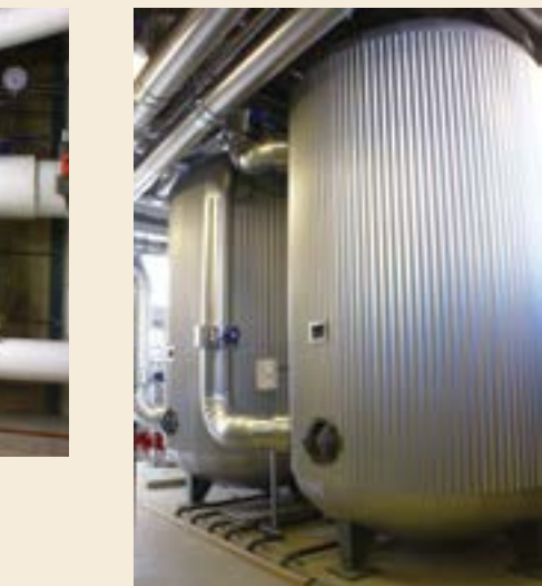
Réservoirs tampons de 22 000 litres d'eau chacun.
