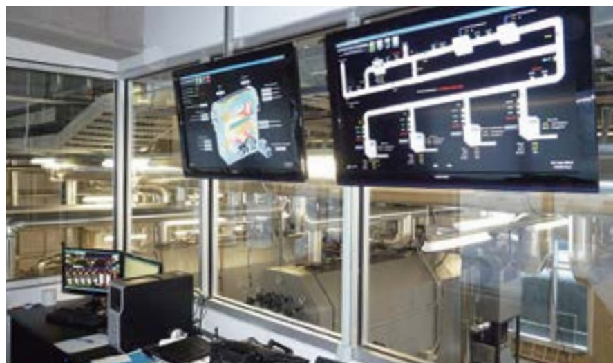
Poste opérateur en surplomb de la chaufferie.
