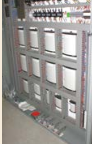
Panneau de contrôle de l'ensemble de la chaufferie, conçu par Régulvar.
