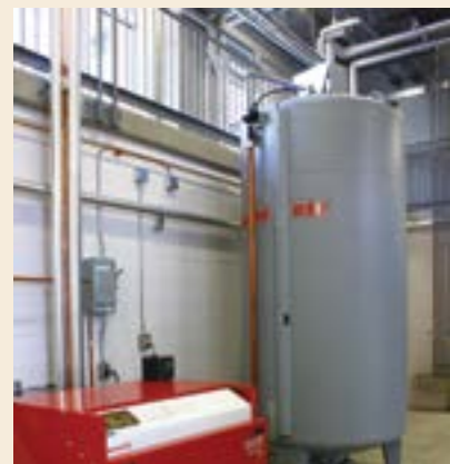
Réservoir elko-mat SW Eder qui gère l'expansion de l'eau dans le réseau.
