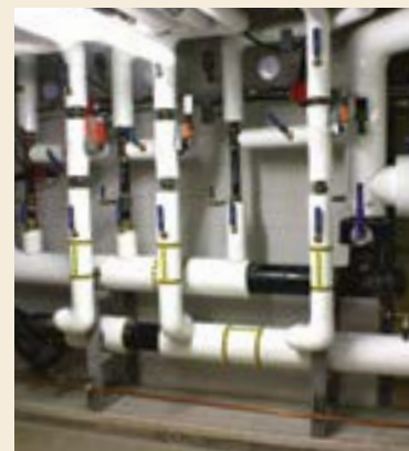
Vannes de contrôle (chauffage, eau chaude sanitaire, fonte de neige).
