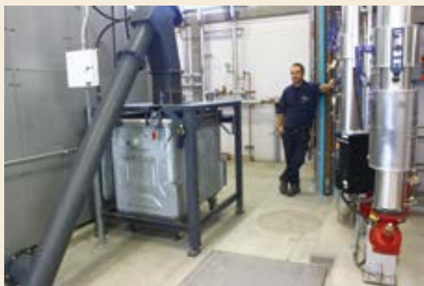
Bac à cendres, se remplit aux 1000 heures (les cendres sont données à des agriculteurs qui les utilisent pour traiter les sols acides).
