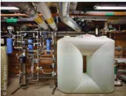
La citerne du système de récupération de l'eau de pluie qui répond à tous les besoins du bâtiment dont l'eau potable, après une filtration appropriée.
