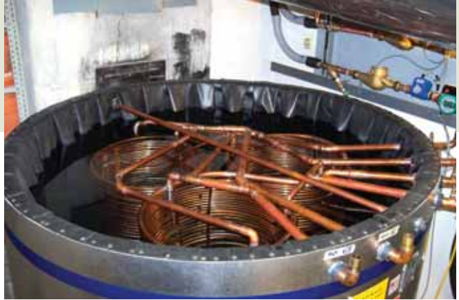
Le réservoir tampon de 1900 L servant de réserve thermique (le couvercle est enlevé pour montrer le réseau de serpentins de cuivre).
