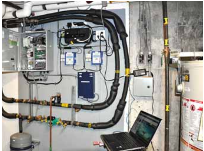
Système de gestion des boucles primaire et secondaire servant au chauffage de l'eau sanitaire incluant un équipement de compilation des données pour fins d'analyse de performance.
