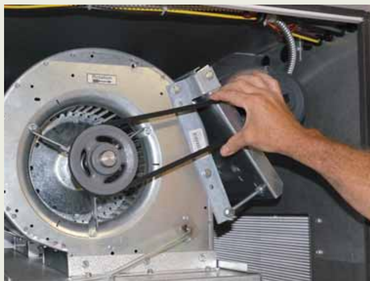
Ensemble moteur-ventilation d'une unité de toit
