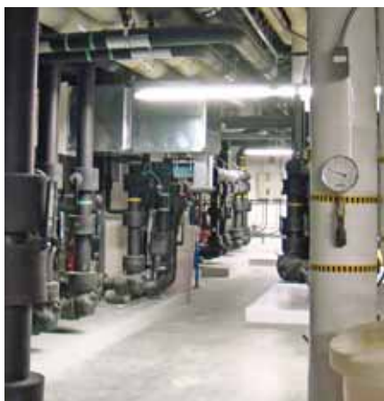
Vue partielle de la salle mécanique située au 2 e étage.
