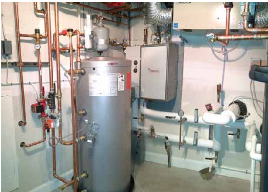
Salle mécanique d'une maison de ville – L'eau arrive de la chaufferie pour se rendre au chauffe-eau.
