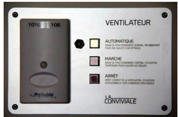
L'interface de contrôle de la ventilation des logements pour les occupants
