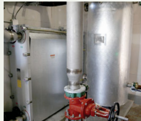
Échangeur à plaques et réservoir de réserve
