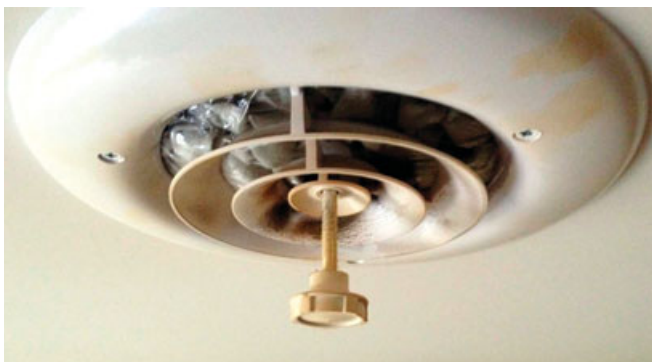
Grille de ventilation obturée par les occupants
