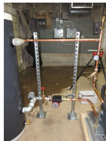
Boucle de refroidissement du réservoir tampon vers le refroidisseur
