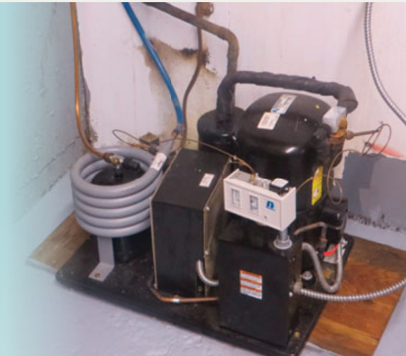
Appareil de refroidissement utilisant de l'eau potable
