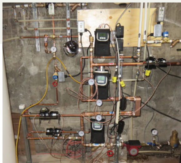
Boucle principale de recirculation vers le réservoir tampon
