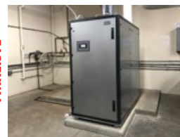
Appareils de chauffage et/ou de climatisation hydronique
