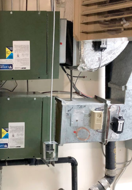
Vieux système de ventilation
