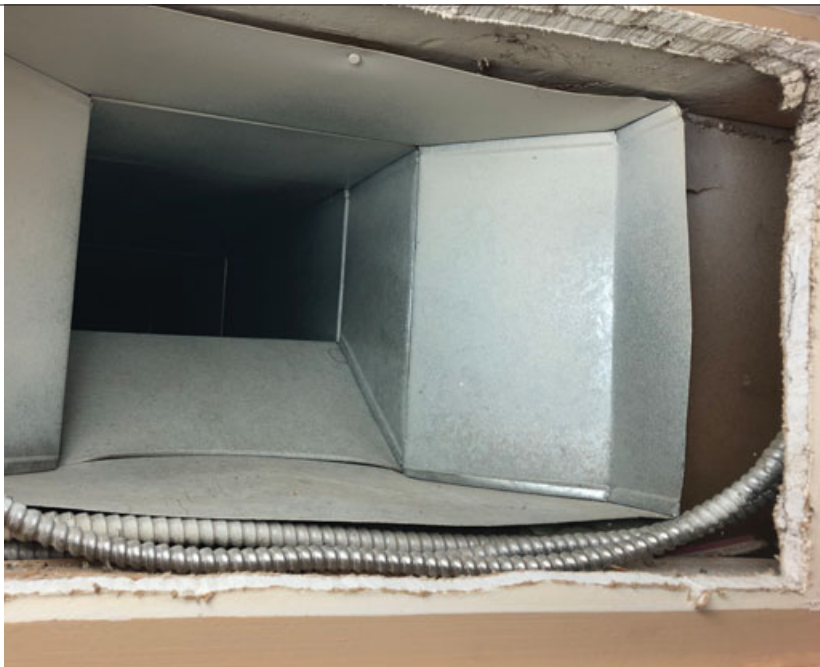
Importante fuite au pourtour d'une sortie d'alimentation.
