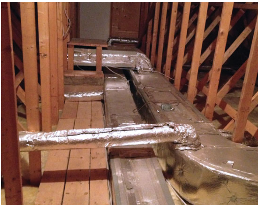
Conduits fuyants installés dans les combles.
