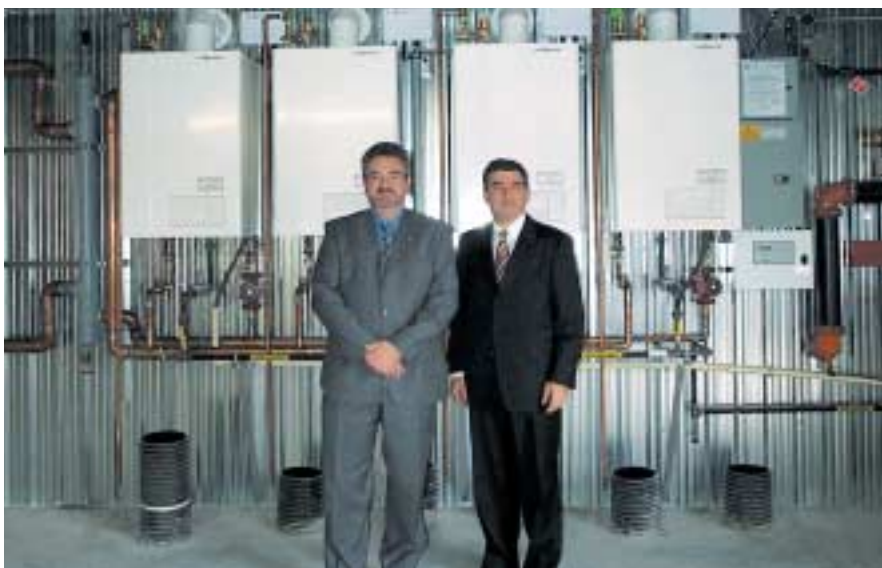
Claude Routhier, d.g. de Poly-Énergie, et Christian Fournelle, d.g. de Groupe Énergie, devant les 4 chaudières à condensation qui chauffent tout le bâtiment.
