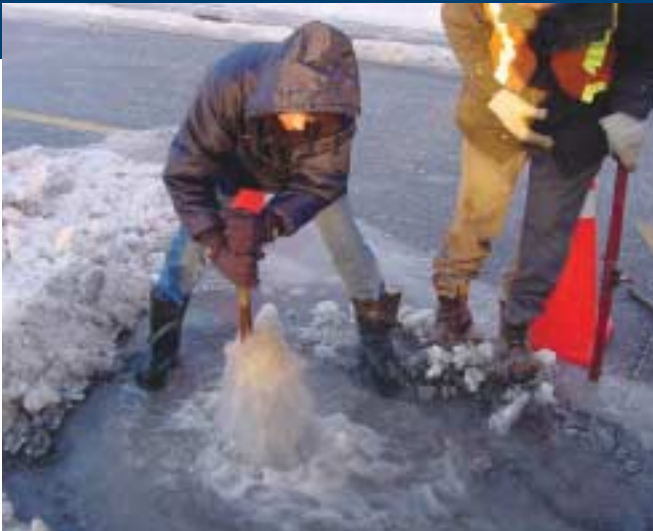
Une dépisteuse de fuite du secteur Sud-Ouest de Montréal en train de fermer une vanne afin qu'on puisse colmater une des nombreuses fuites qui surviennent en hiver.
